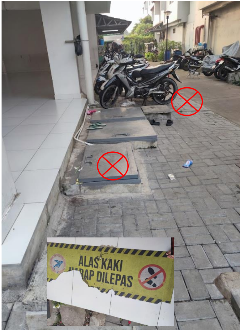
Tidak ada rambu-rambu parkir Tutup Septic tank dijadikan pijakan
