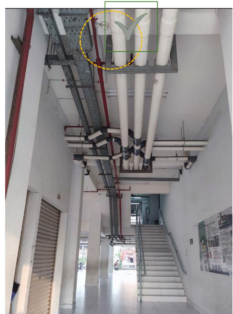
Sprinkler dan fire detector tersedia
