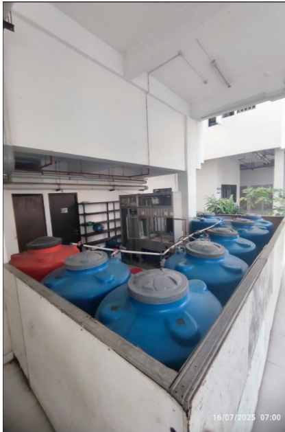
Pengolahan Air Minum yang dikelola penghuni
